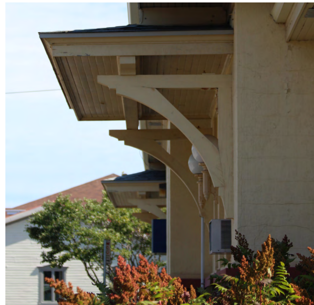
Aisseliers et luminaires, 2023 Sandrine Gauthier, Ville de Rimouski
