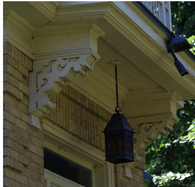
Consoles, marquise et luminaire, 2023 Sandrine Gauthier, Ville de Rimouski
